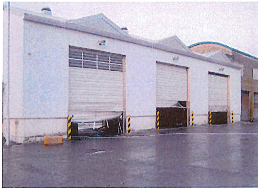
荷捌施設の被害
