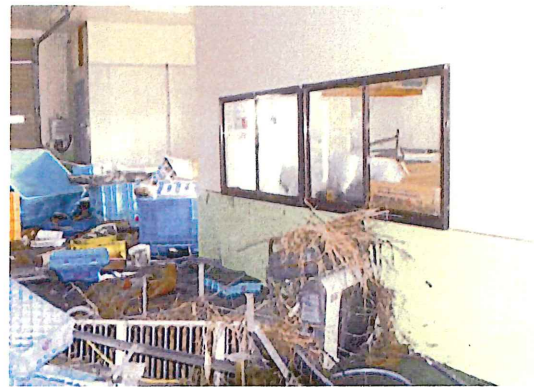
水産加工場の被害
