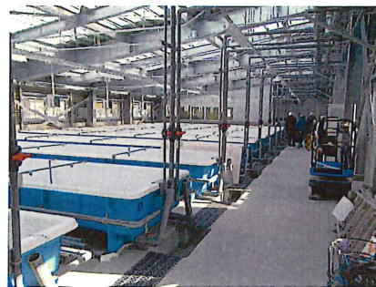
浜中町ウニ種苗生産センター(屋内水槽)
