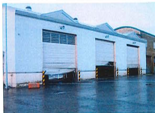
荷捌施設の被害
