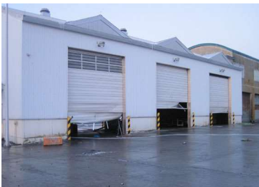
荷捌施設の被害
