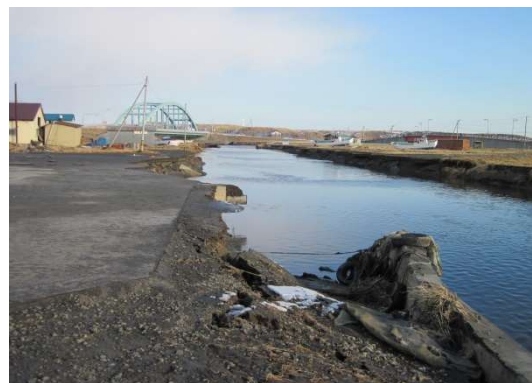
港湾施設の被害
