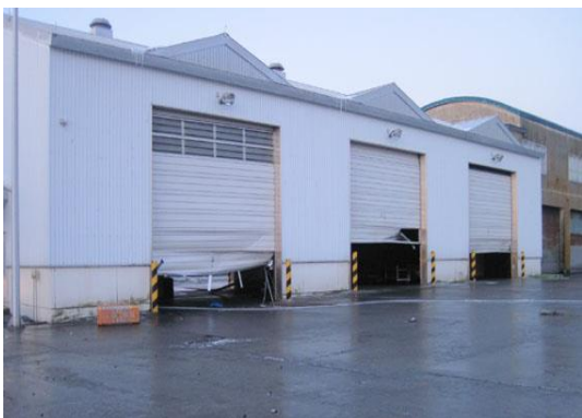
荷捌施設の被害
