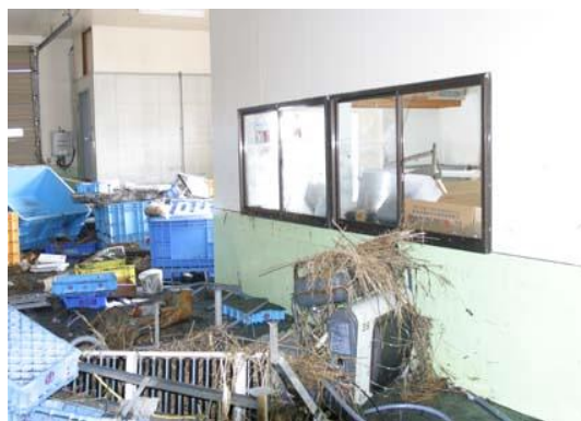
水産加工場の被害
