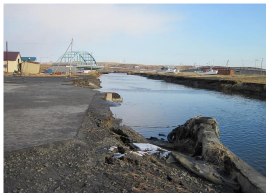
港湾施設の被害
