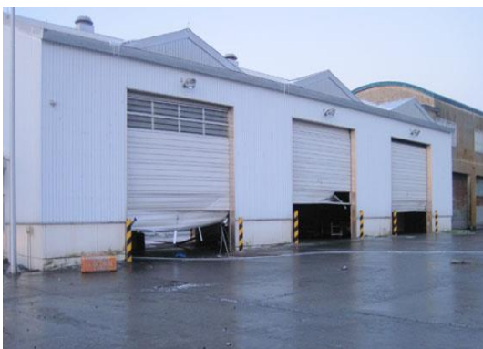
荷捌施設の被害
