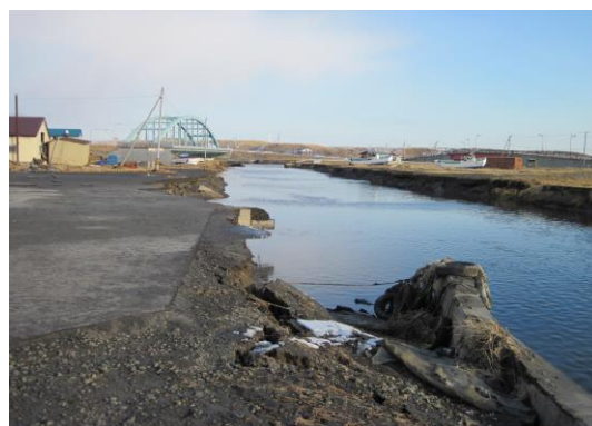
港湾施設の被害
