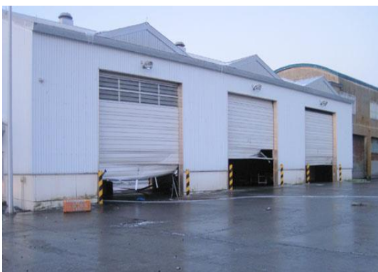
荷捌施設の被害
