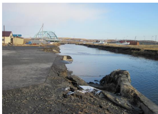
漁船保全施設の被害
