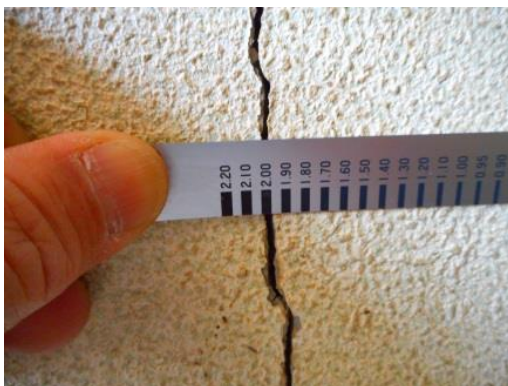
写真 亀裂幅の測定
