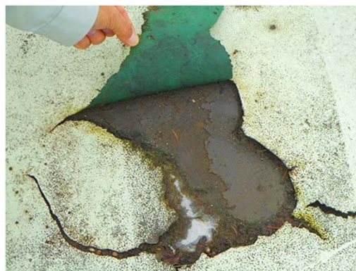
写真 防水層破損状況
