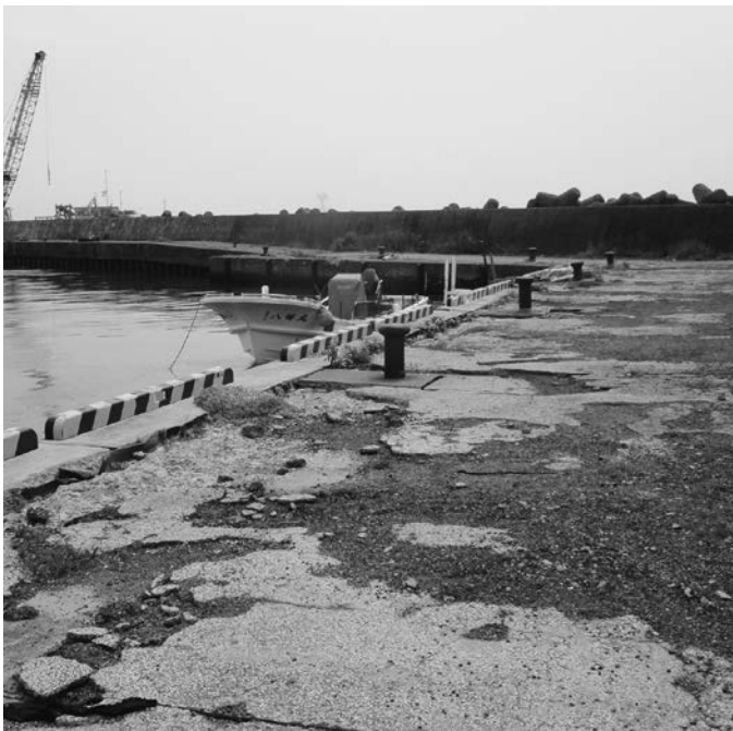
早急な補修が待たれる琵琶瀬漁港 右岸物揚場 (南側の50mで約2億円の工事費)
