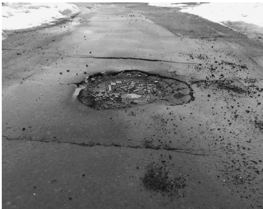
段差ができた下水道マンホール
