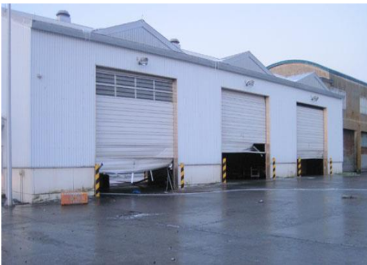
荷捌施設の被害
