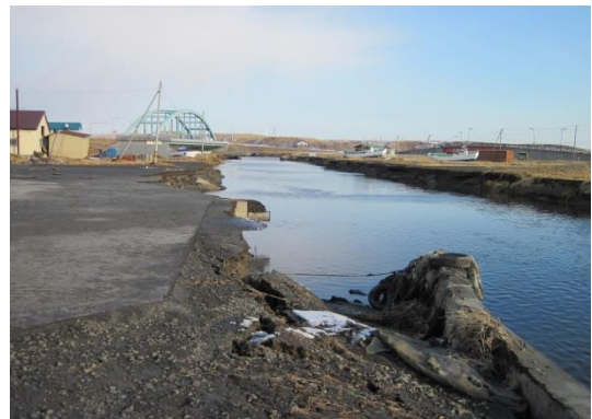
港湾施設の被害
