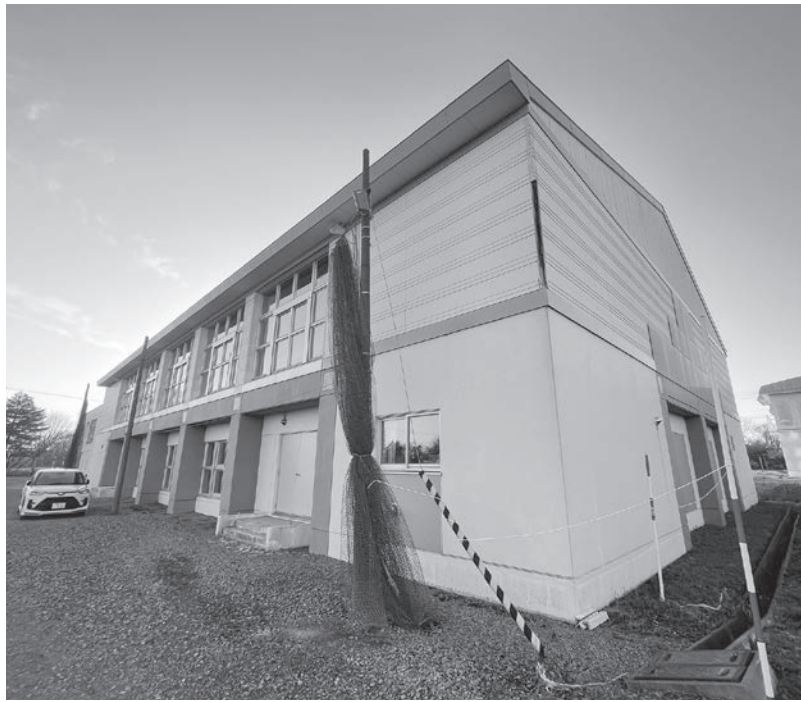
一部が剥がれている浜中中学校体育館外壁
